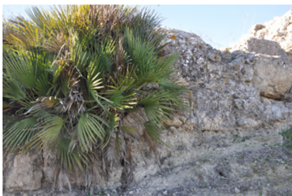
Figura 10. Restos arquitectónicos emergentes correspondientes a la muralla, con núcleo de opus caementicium , en la parte NE (cfr. supra Fig. 9b); se aprecian elementos de vegetación que afectan a su conservación (fotografía propia).
